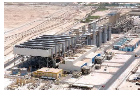
Alba , Бахрейн — Конденсатор с воздушным охлаждением для парогазовой установки мощностью 800 МВт. Проект «под ключ».
